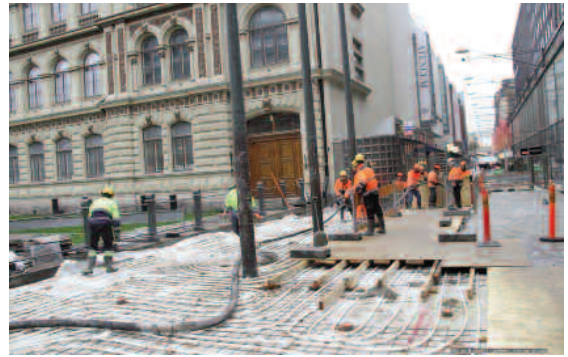
Một trong các tuyến phố được sưởi ấm tại Helsinki (Phần Lan), hoàn toàn bằng nguồn nhiệt thứ cấp từ các ngôi nhà trên phố.
