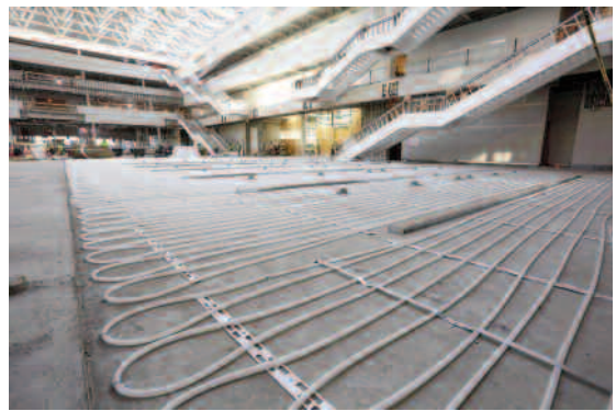
Hệ thống sàn bức xạ Hydronic không chỉ thúc đẩy không khí trong nhà sạch hơn mà còn mang lại hiệu quả sử dụng năng lượng cao hơn so với hệ thống sưởi ấm không khí tiêu chuẩn.
