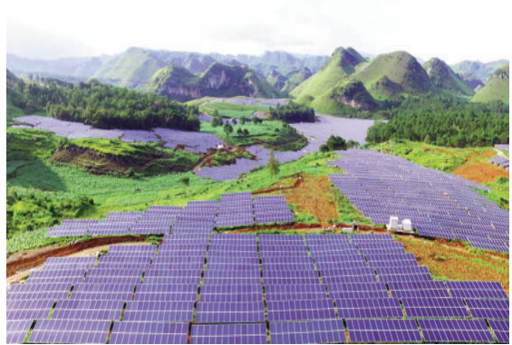
Hệ thống quang điện mặt trời tại tỉnh Quý Châu
