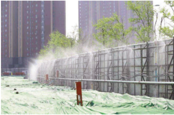
Hệ thống thiết bị phun nước trên công trường xây dựng
