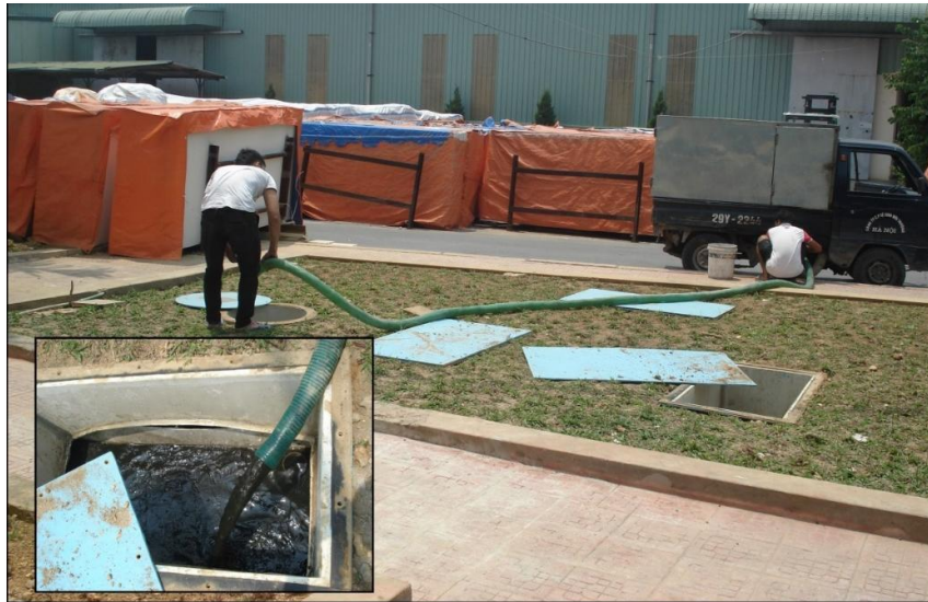
Hình 3.1. Bổ sung bùn hoạt tính vào bể xử lý nước thải.
