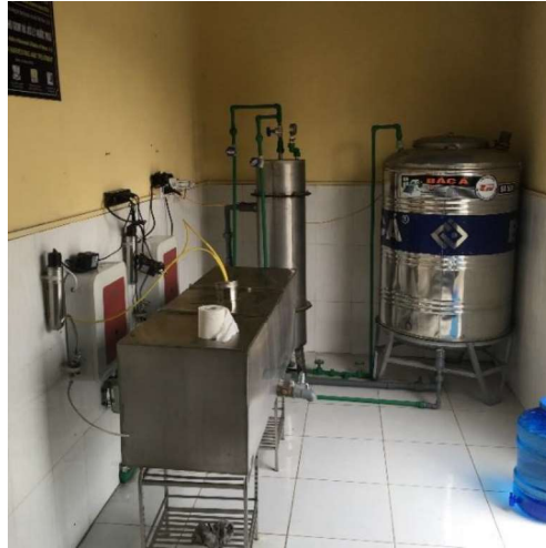
Hình 1.30. Hệ thống xử lý và bồn phân phối nước mưa
