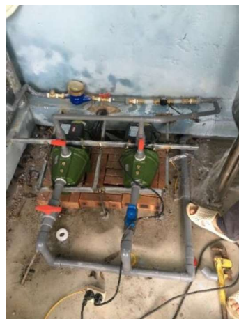
Cụm bơm nước sinh hoạt
