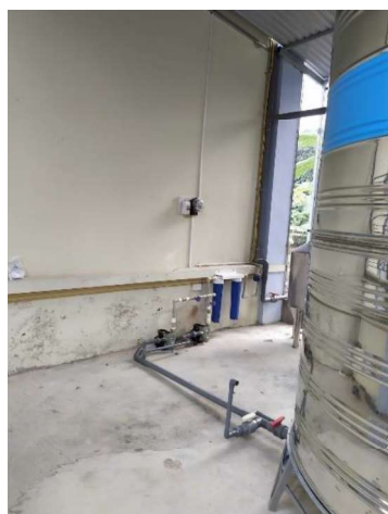
Cụm máy bơm và cột lọc sơ bộ
