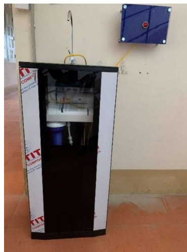
Cây nước cấp nước uống trực tiếp, đèn báo đèn UV hoạt động
