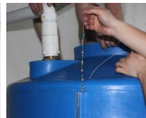
h) Gắn thiết bị đo mực nước trong bể chứa
