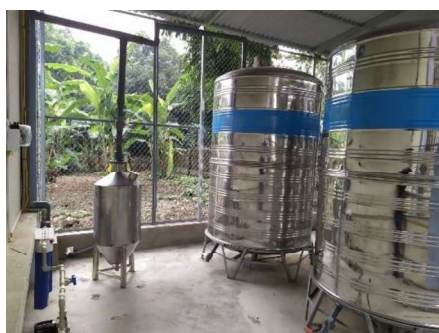
Bồn chứa nước mưa và bồn xả nước mưa đợt đầu
