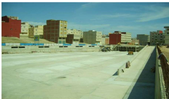
Hình 4.20. Bể lưu trữ nước
