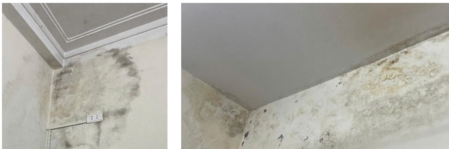
Hình 6.2 – Tường bên trong nhà bị nấm mốc
