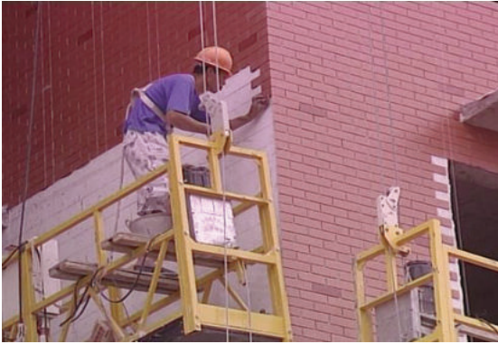
Công nhân xây dựng đang thực hiện ốp vật liệu cách nhiệt, tiết kiệm năng lượng ngoài tường bao công trình
